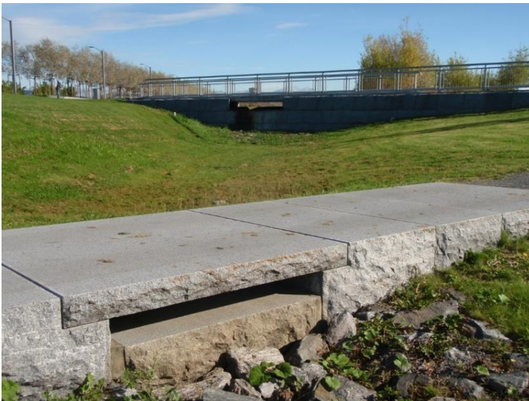
Figur 30. Exempel på utformning av hålldammar (en typ av torra dammar). Foto: WRS.
