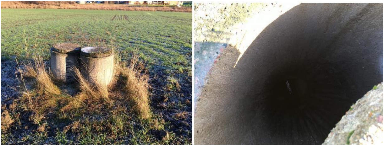
Figur 10. Brunn på lokal ledning som tar emot vatten från brandstationen. Foto: WRS (2020-11-27).
