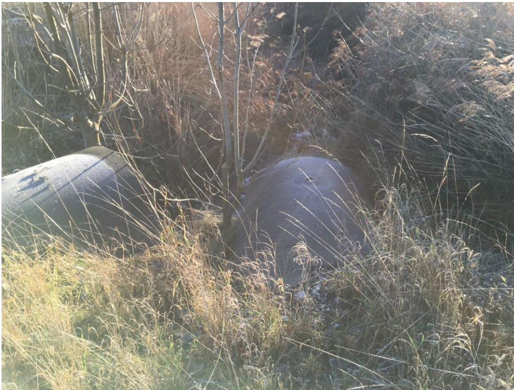
Figur 4. Bilden visar inloppet till krandiket som passerar genom planområdet. Fotot är taget från Ginnlögs väg söderut. I bild ses trumman som passerar under Ginnlögs väg från den lilla dikessnutten norr om vägen samt utloppet dagvattenledning från del av det tekniska avrinningsområdet. Trummorna är av samma dimension med en innerdiameter på 1000 mm.
