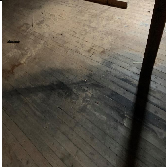
Bild 13: Vindsvåning: läckage från tak synligt på golvbrädor
