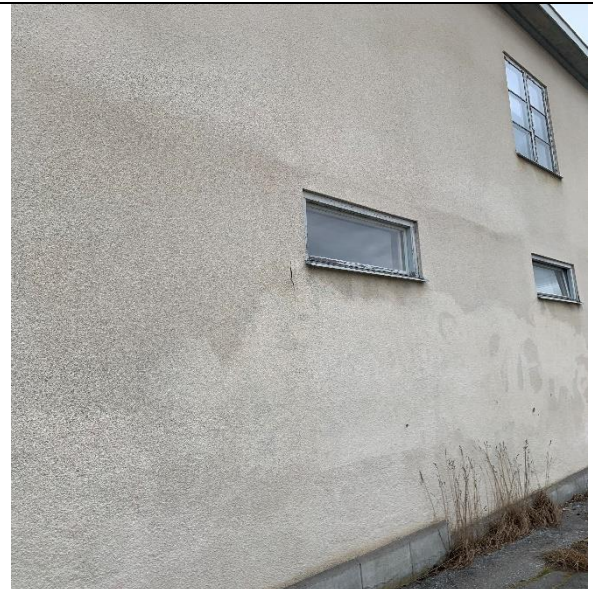
Bild 2: Fasad mot Väster: Skadad samt lös puts, Åtgärder bör ske snarast
