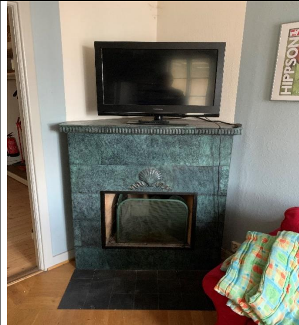
Bild 9: Plan 2: Kakelugn, okänt skick. Åtgärd skall ske innan idrifttagande av kakelugn
