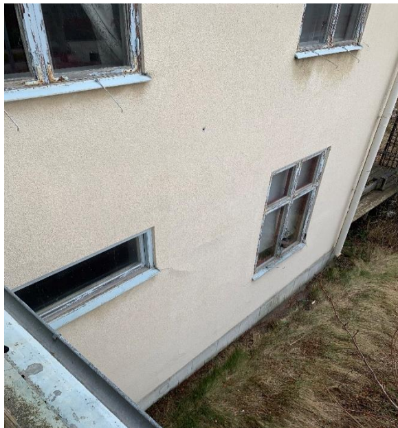
Bild 3: Fasad mot gata: Skadad puts samt fönster som uppvisar fuktskador i nederkant fönsterbågar. Fasad mot Söder (Stationsvägen) Åtgärder bör ske snarast
