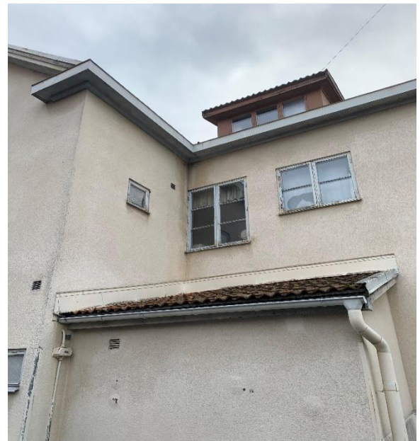
Bild 4: Fasad mot Nord/Ost: Fuktskadad puts vid innerhorn takfot samt puts släpp på utbyggnad. Fönsterbågar har fuktangrepp i nederkant. Åtgärder bör ske snarast
