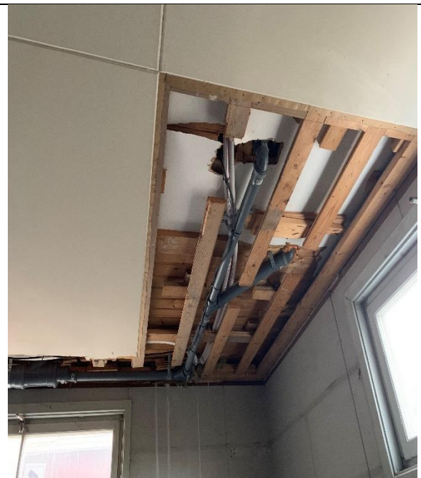
Bild 8: Plan 1:VVS från lägenhet ovan, bjälklaget urkapat samt ej återställt.Åtgärd sker efter konstruktör bedömt hållfastheten på bjälklaget.
