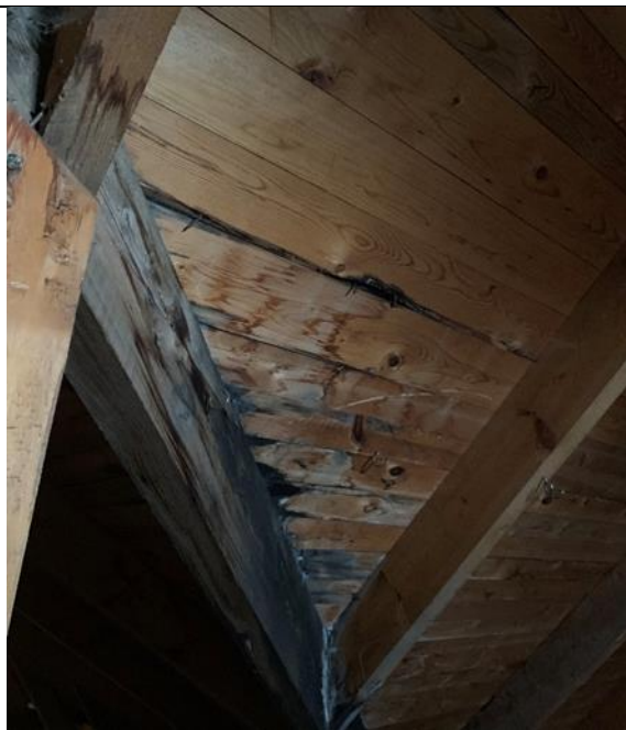
Bild 15: Tak: Närbild på område där troligt vatteninläckage sker. Åtgärd bör ske snarast
