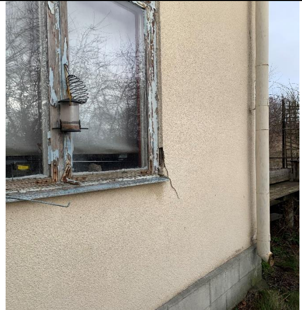
Bild 6: Fasad Söder: Skador på fönsterbågar och karm Åtgärder bör ske snarast
