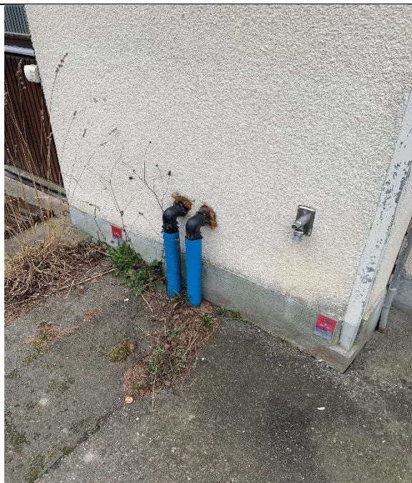
Bild 7: Fasad Nord/Ost :Bergvärmeslang oskyddade mot värmeförluster samt åverkan Åtgärd bör ske snarast
