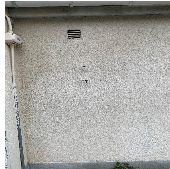
Bild 1: Fasad mot Norr: Skadad puts, Åtgärder bör ske snarast
