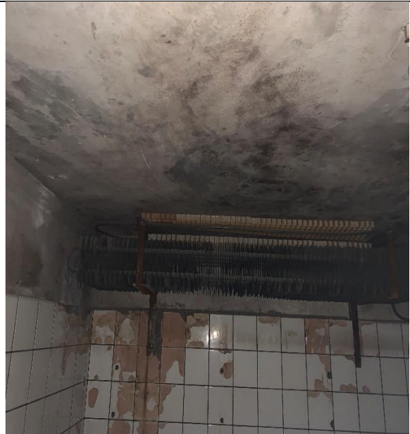
Bild 18: Plan 1: Fuktskador i tak samt på väggar i utbyggd del mot norr Åtgärd bör ske snarast
