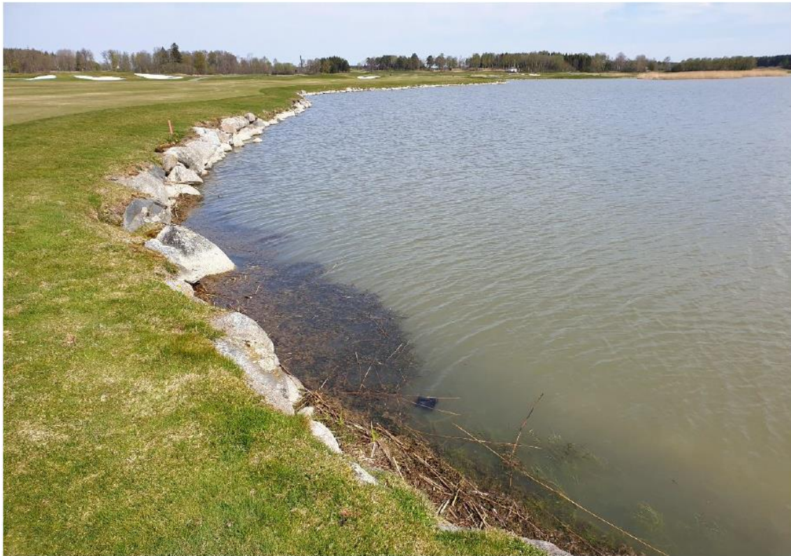
Figur 11. Golfhål 15. Nära strandskoningen finns grumligt vatten ett par meter ut från strandlinjen. På bilden framgår att golfbanans grässvål delvis sjunkit ihop och skapat håligheter.
